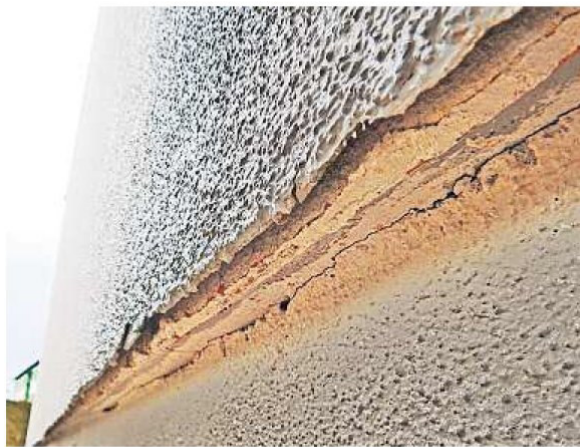
Deutlich zu erkennen: die Bauschäden an der Fassade der Grundschule in Weitramsdorf. Foto: Konrad Fischer
